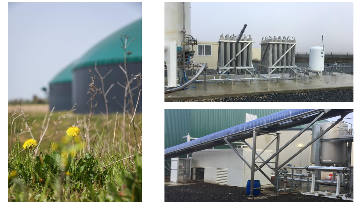
Figure 4 : Unité de méthanisation de Méthabraye. La photo en haut à droite montre le site d'injection. La photo en bas à droite montre le poste de liquéfaction fourni par VerdeMobil.
